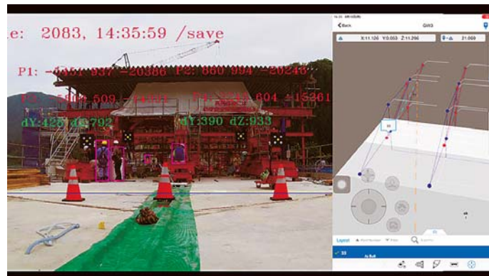
ワーゲン移動監視システム
